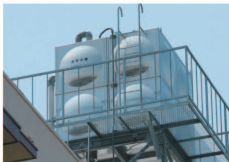
給水タンク、高架水槽
