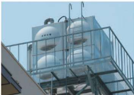
給水タンク、高架水槽
